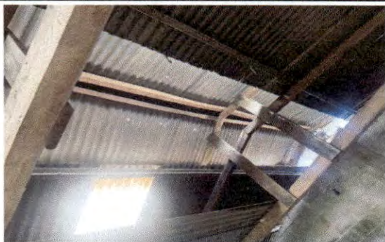
Foto 7: Estructura de madera vista interior de cocina en mal estado.
