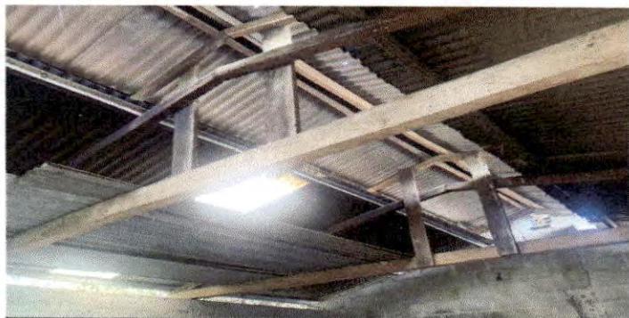
Foto 8: Techo en mal estado por corrosión.
