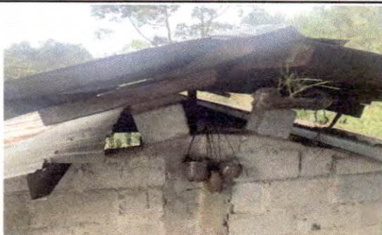
Foto 5: Estructura actual de madera dañada.
