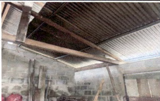
Foto 3: Estructura en el interior de cocina en mal estado.
