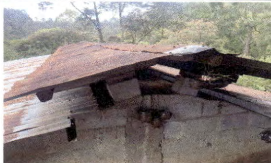
Foto 11: Láminas del techo de cocina en mal estado.
