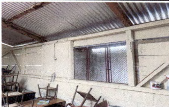
Foto 10: Muros de madera en mal estado.
