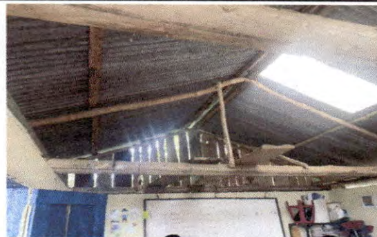
Foto 2: Estructura de madera en interior de Módulo 2 en mal estado.
