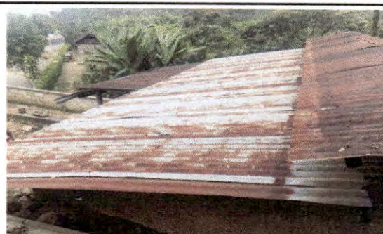
Foto 6: Láminas dañadas por corrosión.
